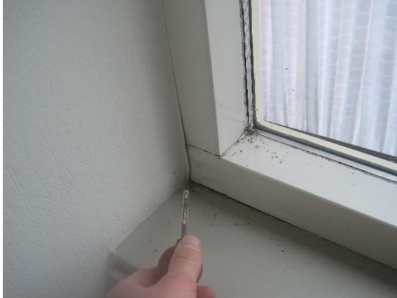
Luchtlek ter plaatse van kozijn / vensterbank aansluiting achtergevel
