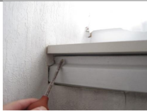
Luchtlek ter plaatse van vensterbank
