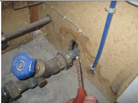
Luchtlekken rondom doorvoeringen in meterkast
