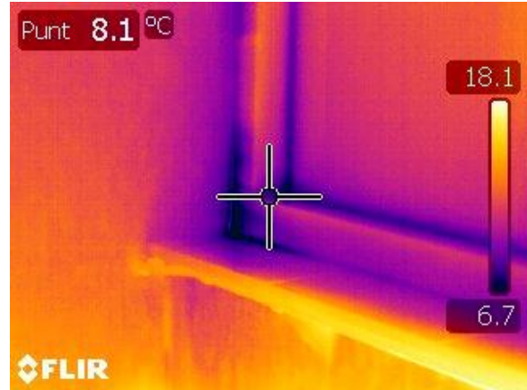
Luchtlek ter plaatse van beglazing voorgevel
