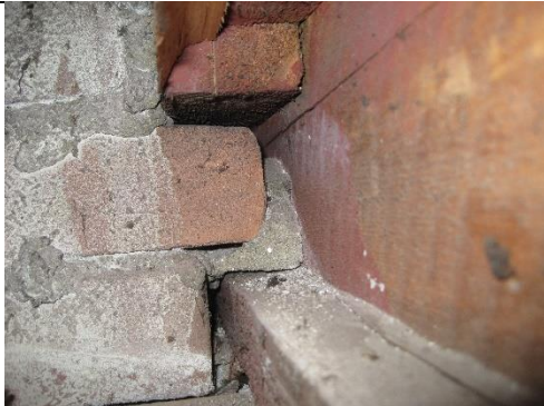
Luchtlek ter plaatse van oplegging vloerbalken in gevel
