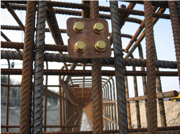
Figuur 120 Fundatieaarding. Een zogenaamde aardplaat; messing verbindingen om het staal aan te sluiten aan het aardsysteem in het gebouw; een dergelijke wapening vormt (ingegoten in het beton) een prima aardsysteem
