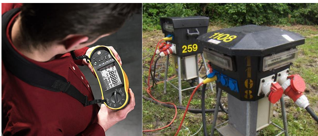
Figuur 166 Het inspecteren van een tijdelijke installatie
