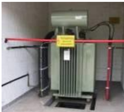
Figuur 32 Distributietransformator in de middelste ruimte van het transformatorstation
