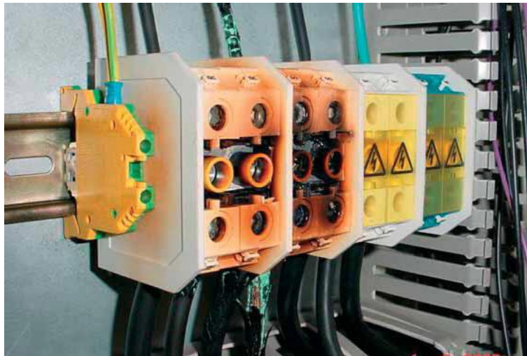
Figuur 26 Gevolgen van slechte elektrische verbindingen
