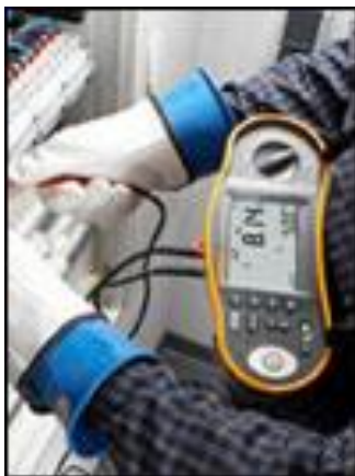
Figuur 71 Meting als controle op de vraag of de aardlekschakelaar nog snel genoeg reageert bij de juiste stroomwaarde
