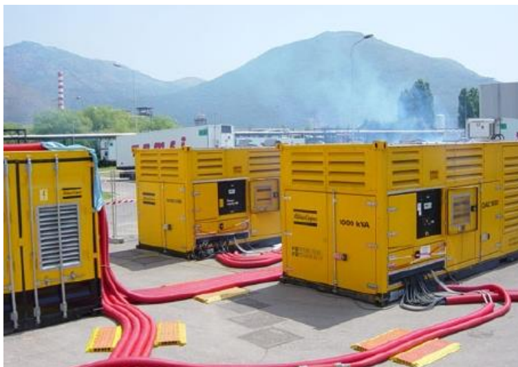
Figuur 53 Opstelplaats van aggregaten: ruimte om te bedienen en correcte vluchtwegen
