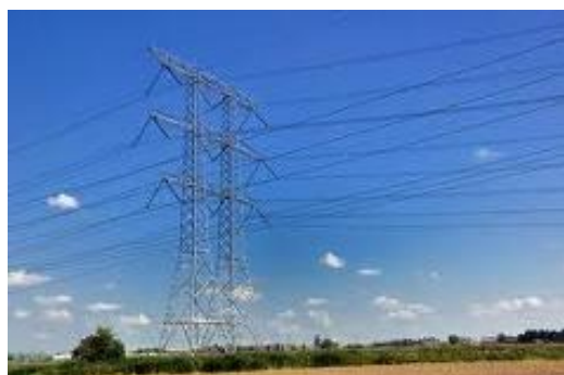
Figuur 135 Bovenleiding hoogspanning
