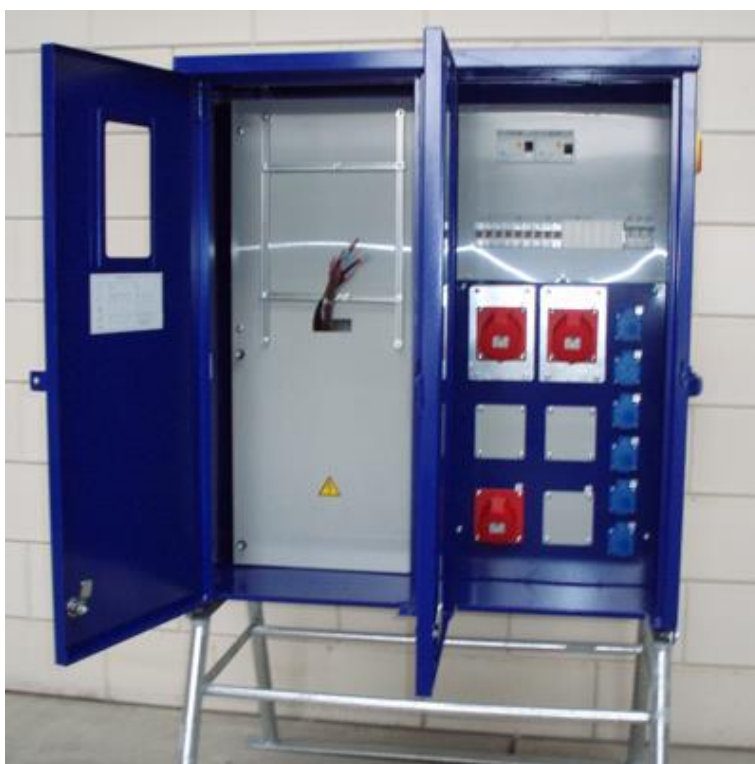
Figuur 46 Bouwkast voor het aansluiten van de voedende kabel van het netbedrijf
