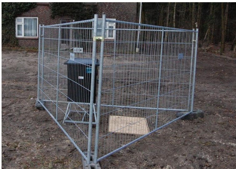
Figuur 54 Afschermen kan met behulp van hekken, deze zorgen dat schakel- en verdeelinrichtingen afgesloten zijn
