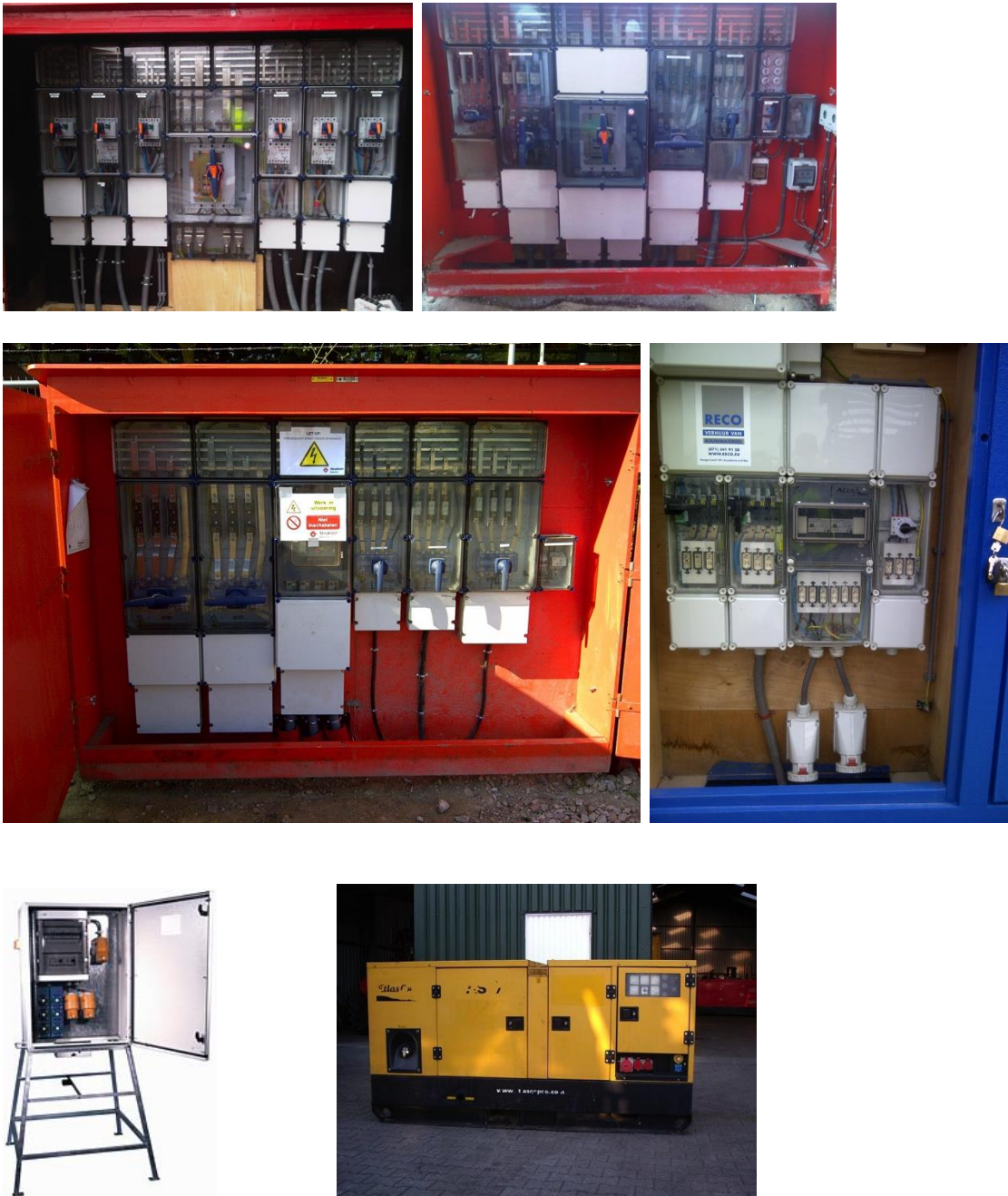
Figuur 149 Zes voorbeelden van elektrotechnische ruimten op een bouwlocatie
