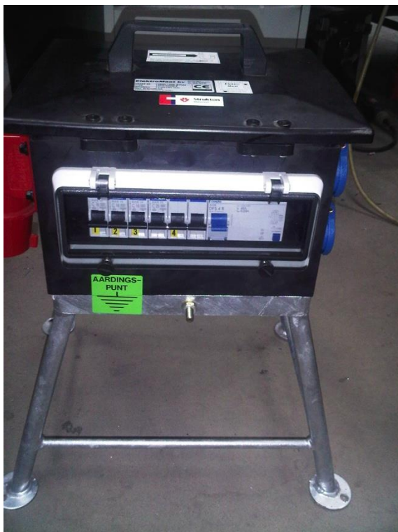
Figuur 133 Bouwkast met een aardnok aan stalen frame, verbonden met inwendig aardrail PE. Aardnok is gemarkeerd met pictogram sticker
