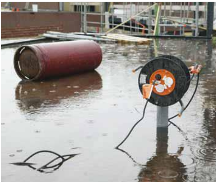
Figuur 100 Een voorbeeld van wellicht een goed arbeidsmiddel dat erg onveilig wordt gebruikt
