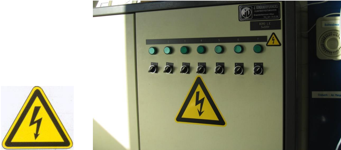
Figuur 154 Gevaarsymbool elektriciteit
