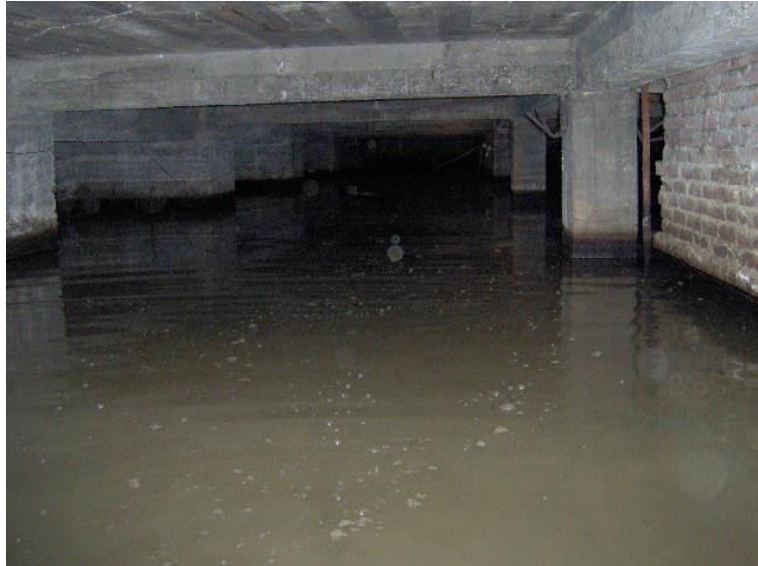
Figuur 91 Voorbeeld van een nauwe geleidende ruimte met vocht
