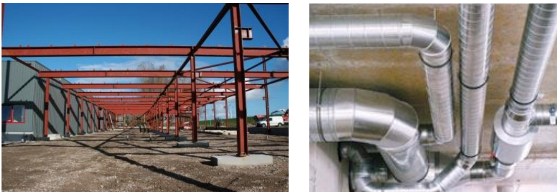
Figuur 129 Een vreemd geleidend deel zoals een stalen constructie van een gebouw, en luchtbehandelingsinstallaties moeten worden geaard
