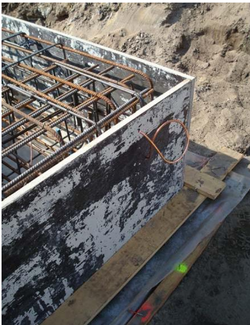
Figuur 121 Aardstek: koperdraad uit het beton
